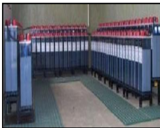
Banc de batteries
