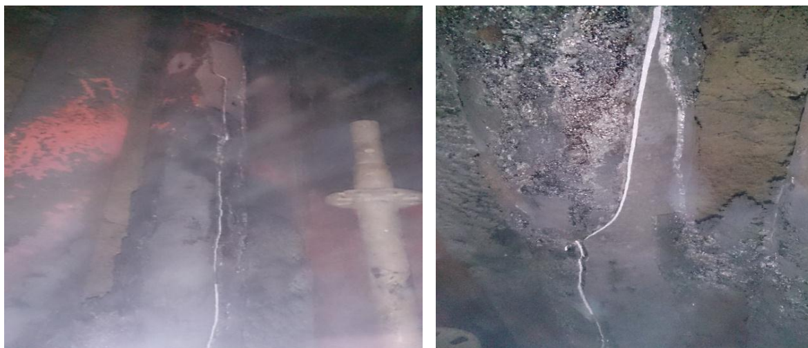
Figure VI.9. Fissure directionnelle du tube N°18 du serpentin N°2
