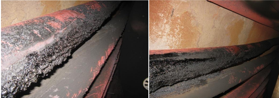
Figure VI.4. Fuite de la charge dans le tube numéro 17.
