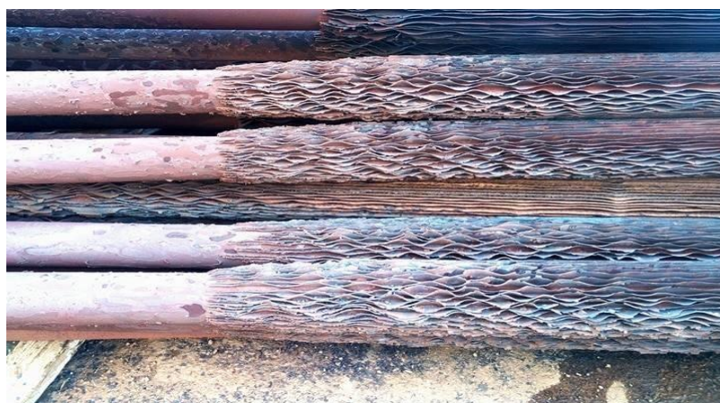
Figure VI.10. Forte dégradation par oxydation sous l'effet de haute température des ailettes des tubes
