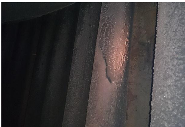
Figure VI.11. Oxydation des tubes du serpentin N°2
