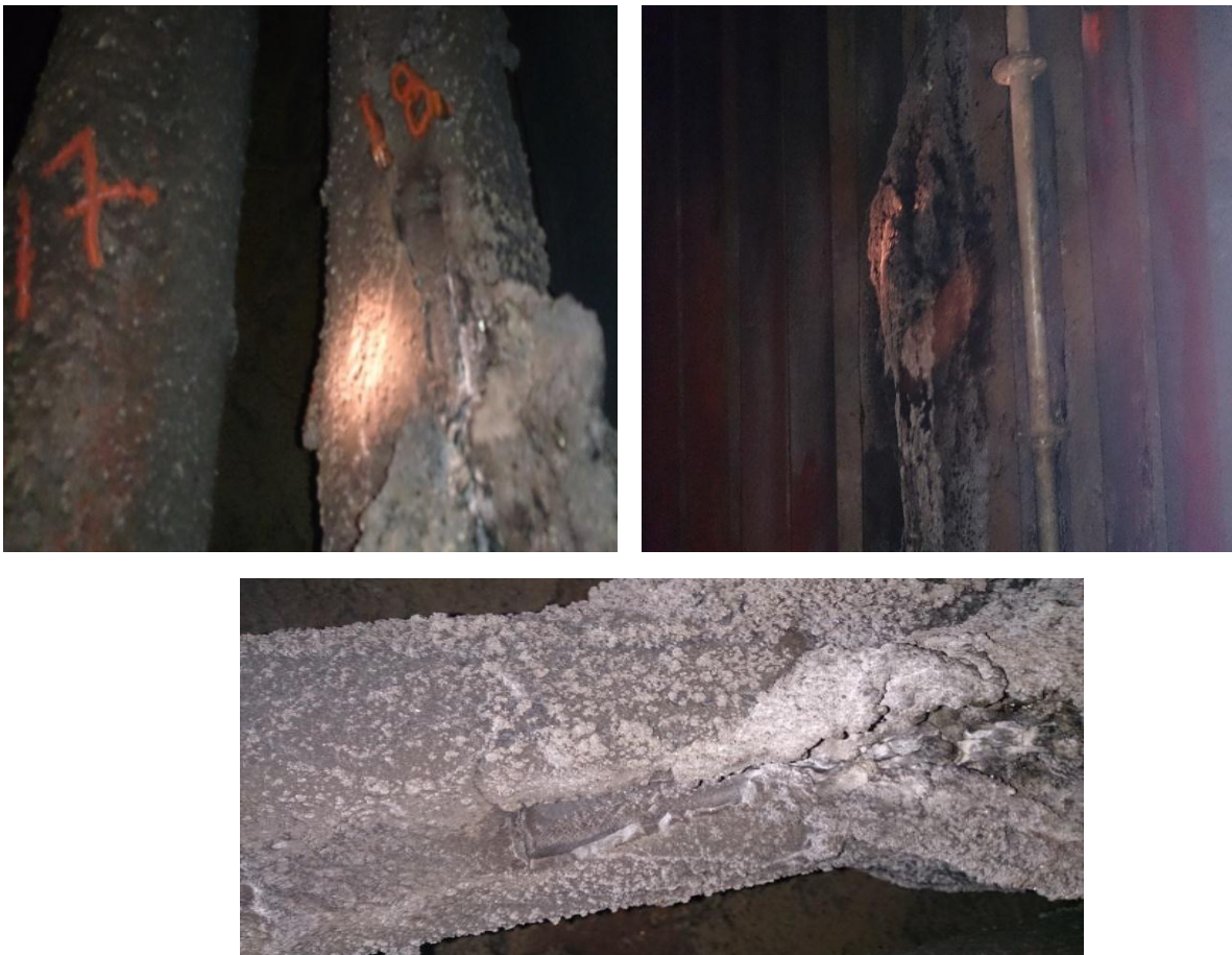
Figure VI.8. Nid d'hydrocarbures sur le tube N°18
