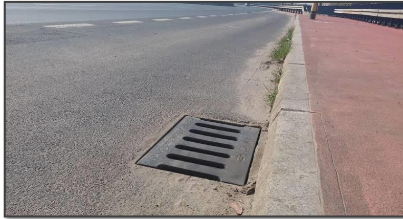
الصورة - 04 - بالوعة تصريف مياه الأمطار
