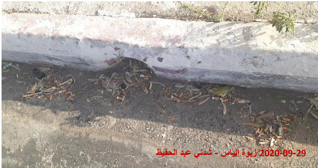
الصورة -15- حالة بالوعة الصرف الصحي في النقطة السوداء 05
