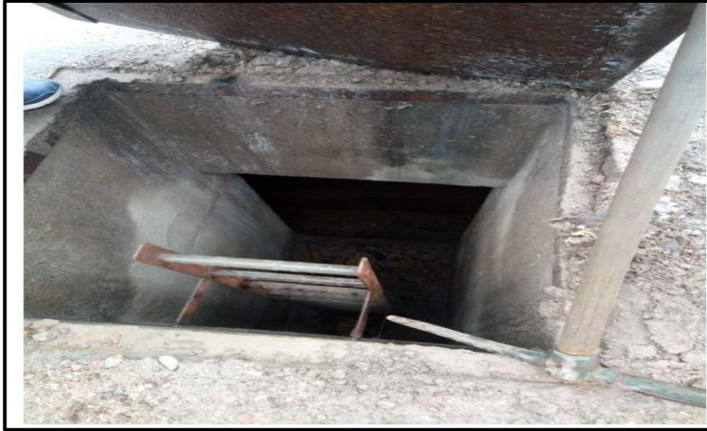
الصورة -3- غرفة تفتيش
