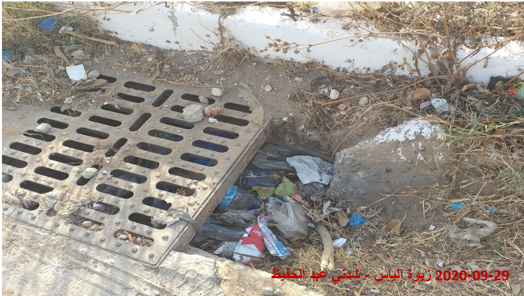
الصورة -17- حالة بالوعة الصرف الصحي في النقطة السوداء 06
