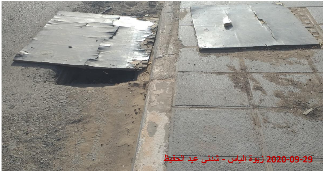
الصورة -13- حالة بالوعة الصرف الصحي في النقطة السوداء 04
