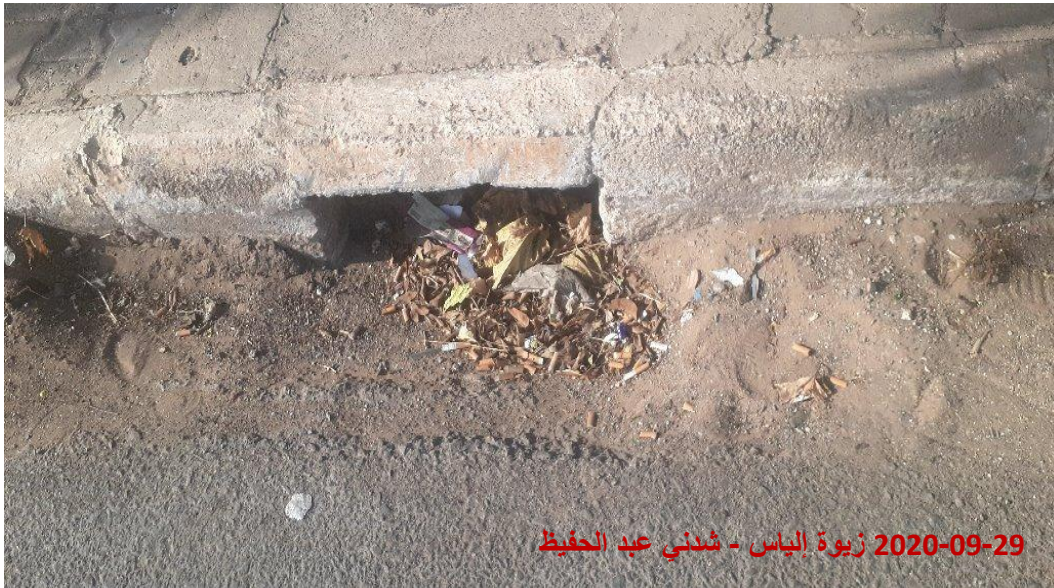
الصورة -07- حالة بالوعة الصرف الصحي في النقطة السوداء 01
