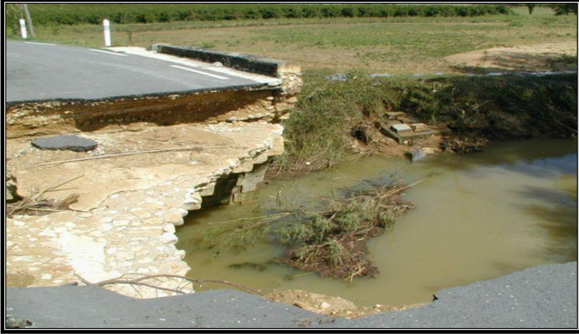
الصورة رقم 04 : تهديم البنية التحتية
