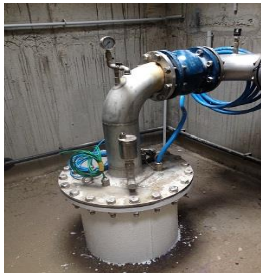
Figure N°22 : la tête de puits étanche en acier inoxydable (Le périmètre de protection immédiat)
