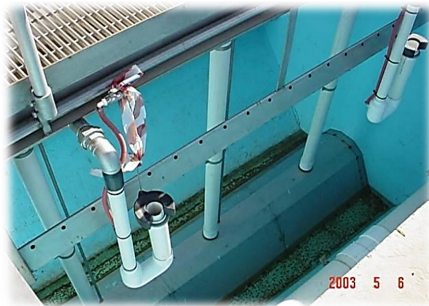
Figure 17 : Bassin Clarificateur (Document GP1/Z, 2003)
