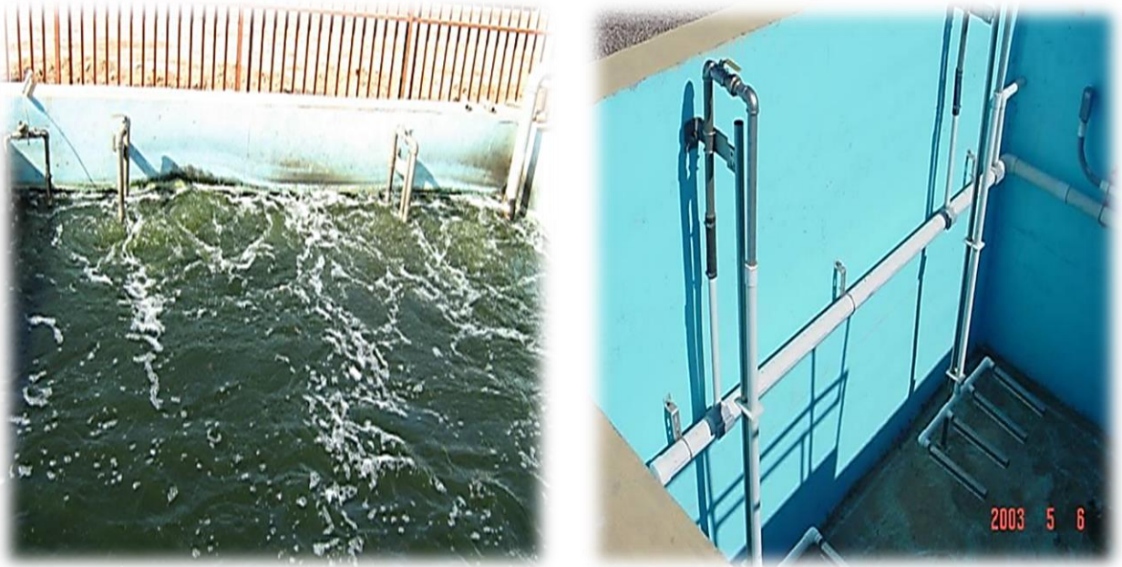
Figure 15 : Bassin de nitrification (Document GP1/Z, 2003)
