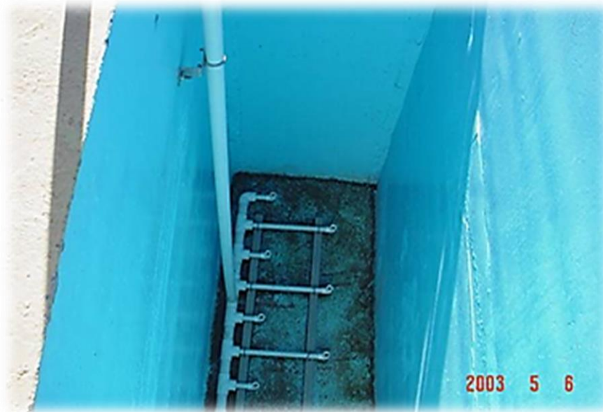
Figure 18 : Bassin de désinfection (Document GP1/Z, 2003)
