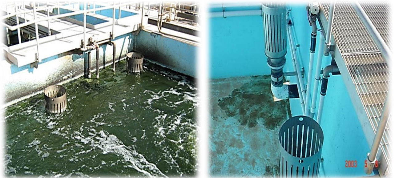
Figure 16 : Bassin de dénitrification puis filtration (Document GP1/Z, 2003)
