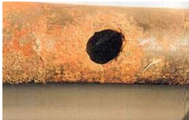
Figure I. 24: Conduite subit une corrosion externe par courant vagabonds (BLINDU.I, 2004)
