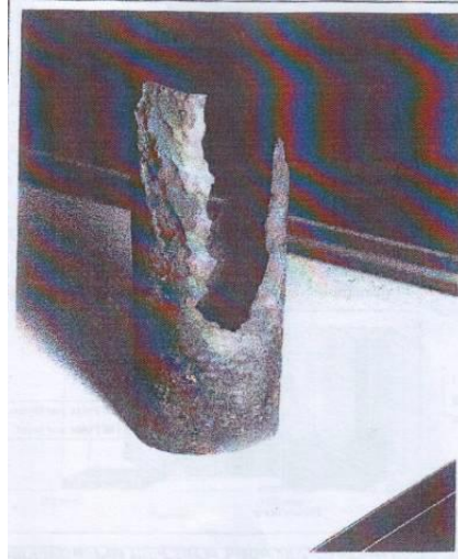
Figure I. 14: Une conduite ayant subi une rupture MERZOUK.N,2005
