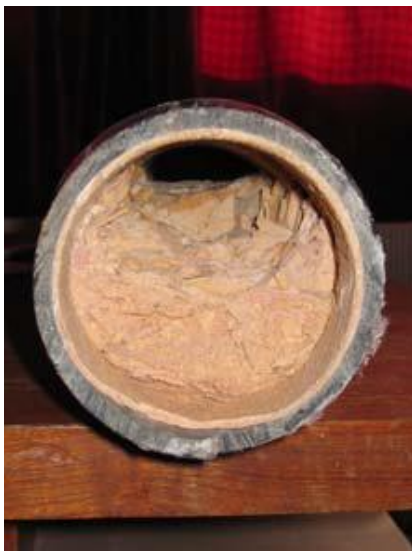
Figure V. 15 Conduite de PVC
