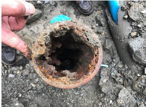
Figure I. 23: Conduite subi une corrosion interne EISENBEIS.P,2004
