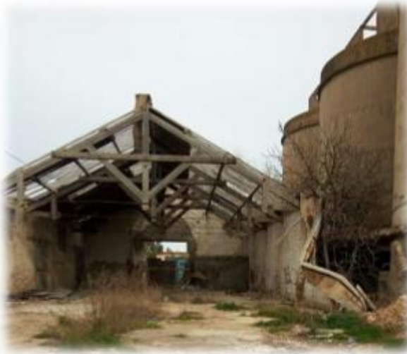
figure16: Des dégradation structurelles sur la toiture
