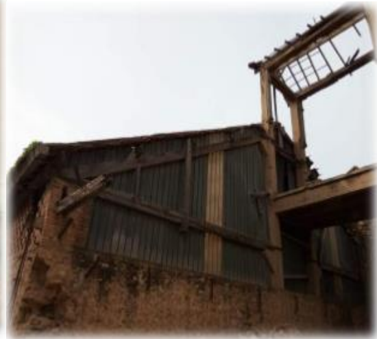
figure 17 : Des traces d'humidité due à la stagnation et à l'infiltration d'eau pluviale. avec des fissures sur le mur extérieur
