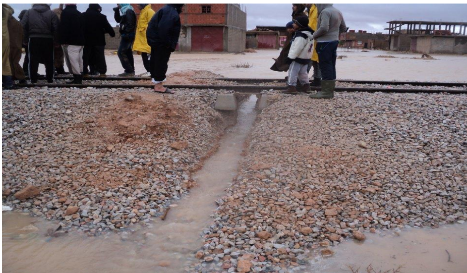
Figure20 : la voie ferrée Mecheria- Béchar ce tracé à former une digue prolongée.
