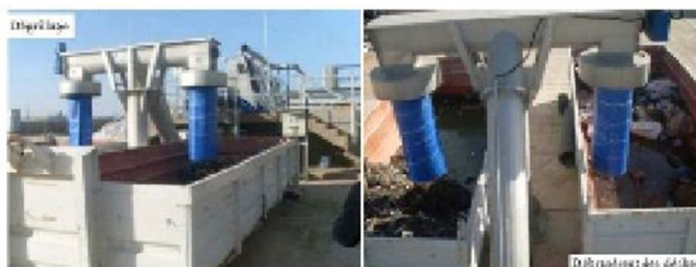
Figure 14: Dégrilleur de la STEP d'el Kerma
