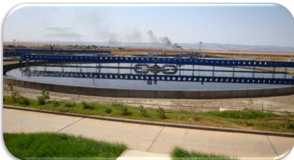
Figure 18: Poste de décantation secondaire
