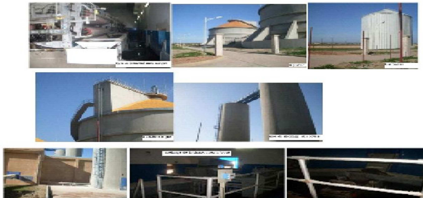
Figure 17: Traitement à boue activée STEP d'el Kerma
