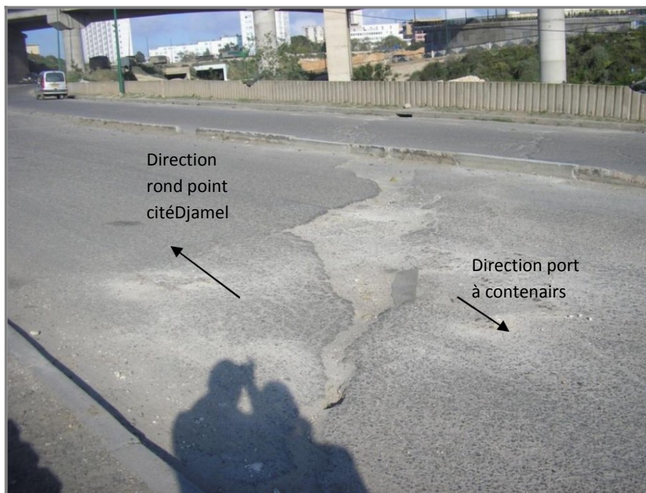
Fig. 23.- Fissure affectant la chaussée menant au port à conteneurs
