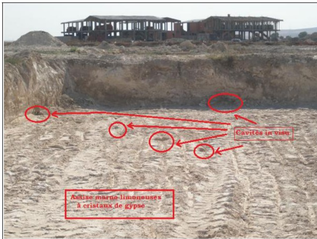
Fig. 38 - Assise géologique représentée par les limons marno-gypseux, parsemé d'un réseau de cavités
