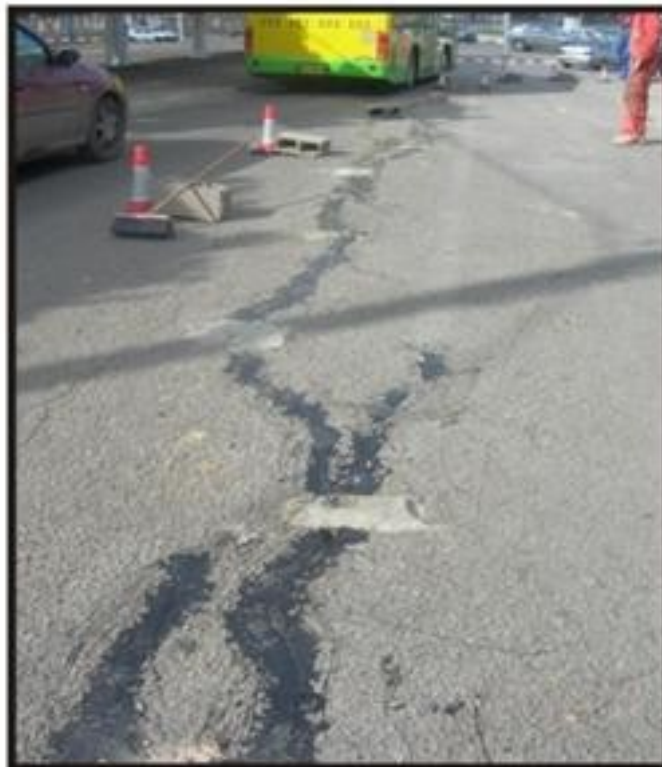
Fig. 24 – Fissuration d'un tronçon de l'avenue débouchant sur le pont Zabana
