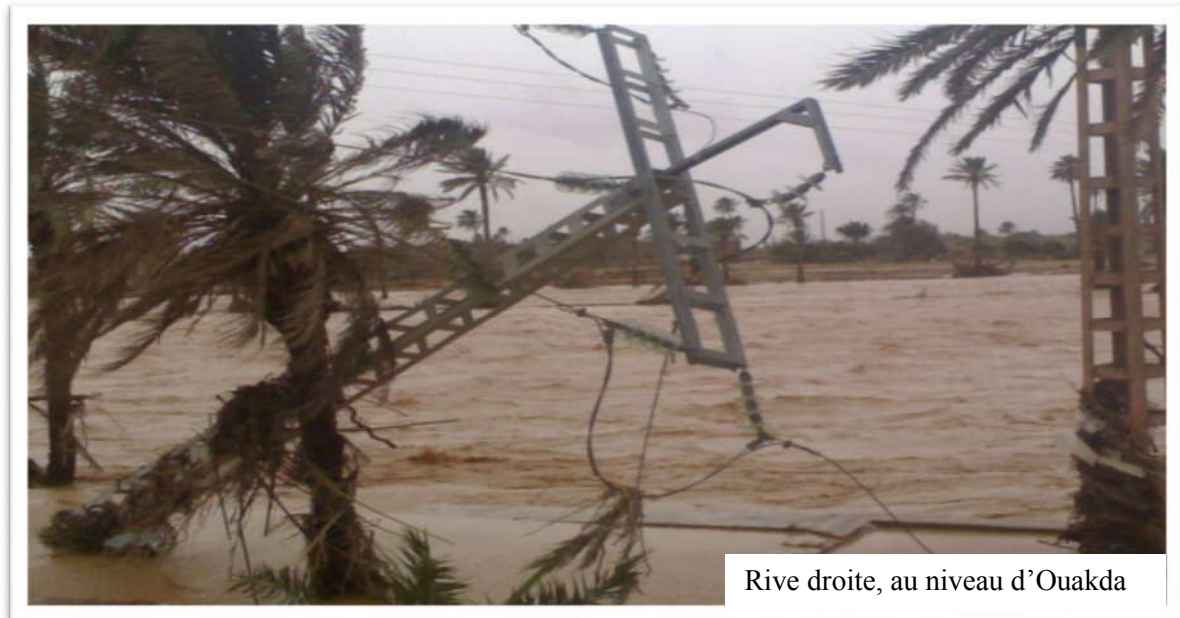
Image N°08 : Destruction du réseau électrique
