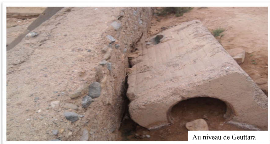
Image N°09 : Dégâts du réseau assainissement
