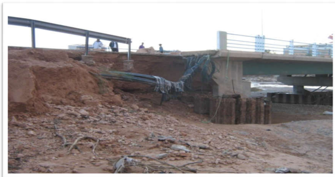
Image N°10 : Détérioration des ponts du centre ville
