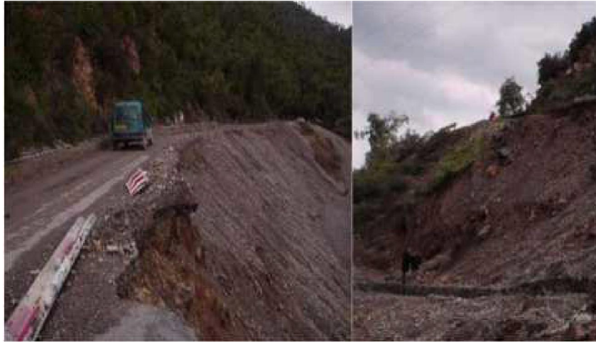
Figure 13 : Route affecté par le glissement (adekar).
