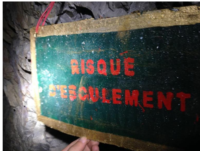
Fig. 31 : Panneau montre le risque d'éboulement dans les galeries
