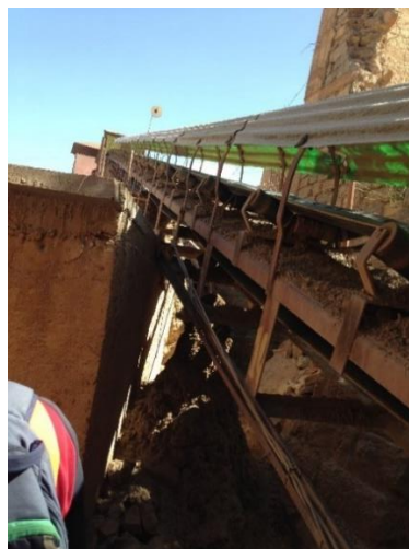
Fig. 28 : Vue du tunnel de captage des poussières.
