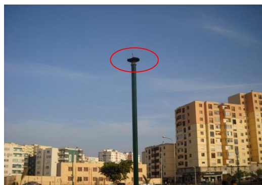
Photo N°35 : Eclairage endommagé au niveau du jardin Es Sabah Source : Enquête terrain 2016
