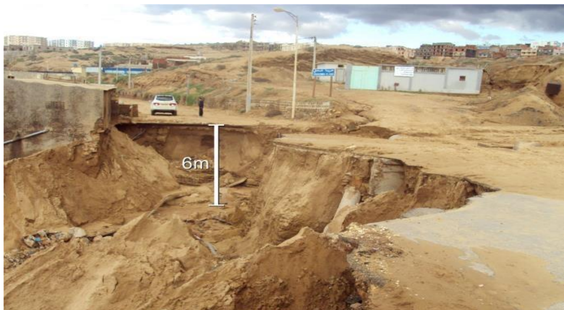
Photo 16: Un glissement de terrain à Kharrouba en 2012(DPW,2012)
