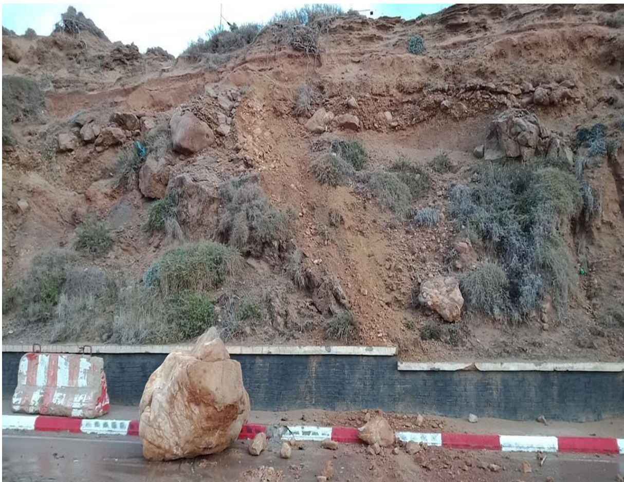
chute d'un gros rocher tombant du talus 2020 Source : page facebook de la wilaya de mostaganem
