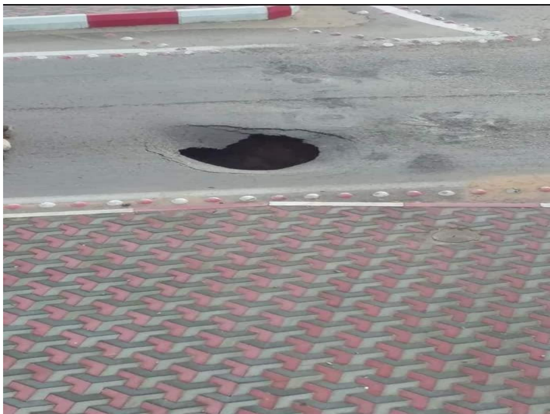
crevasse au niveau de la route (descente des bâtiments michelere tigiditte)
