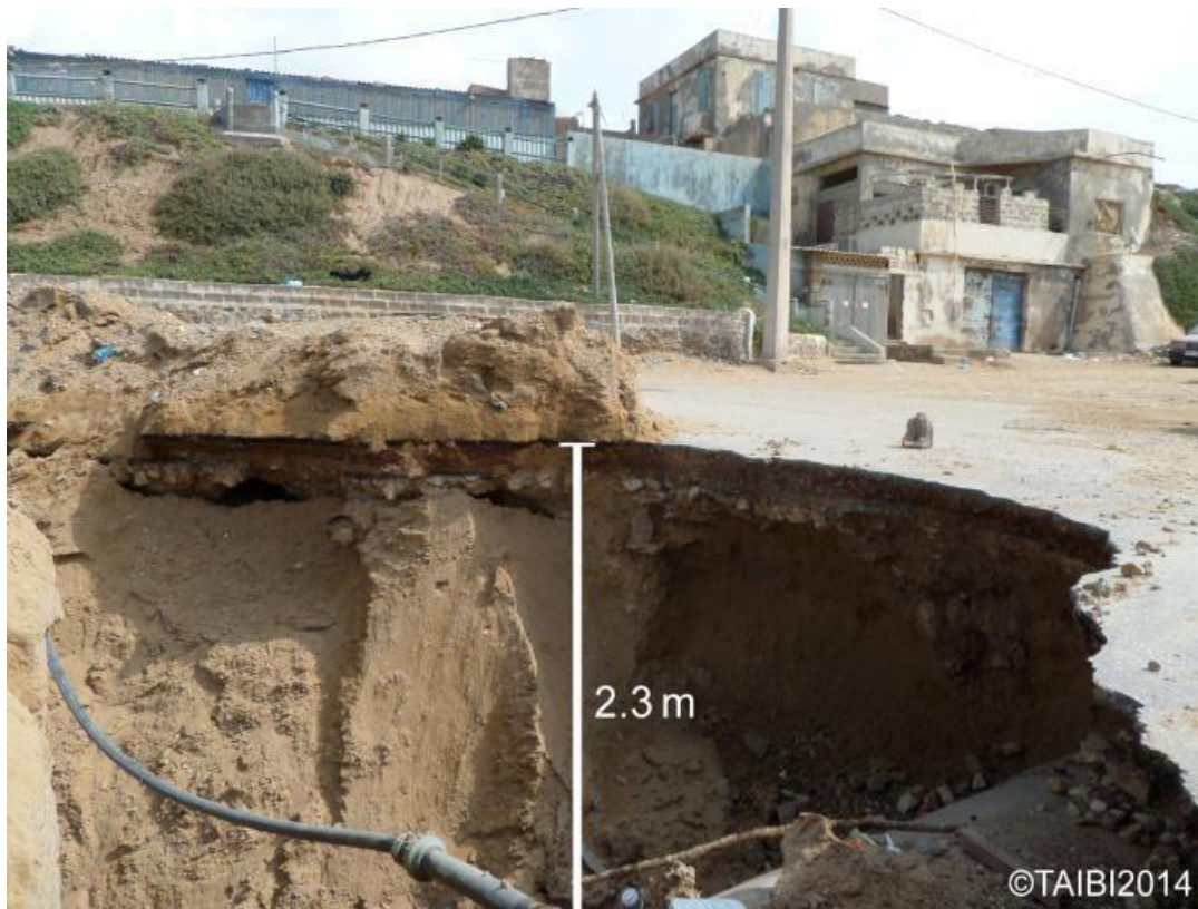
Photo 17:Affaissement de la route par glissement de terrain
