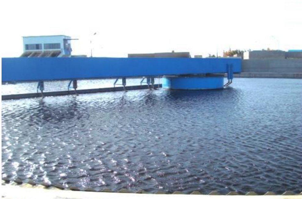
Figure .10 : décanteur secondaire « clarificateur »
