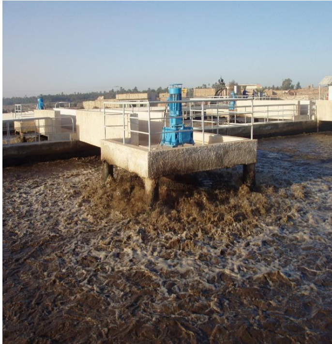
Figure .24 : Bassin d'aération
