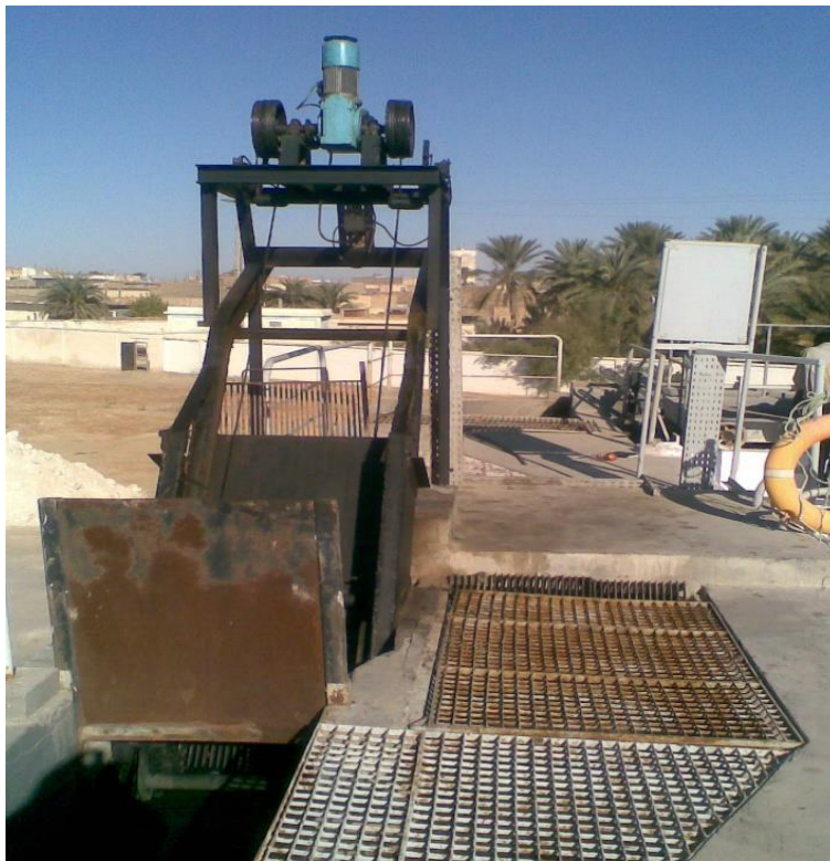
Figure .23 : Dégrilleur mécanique
