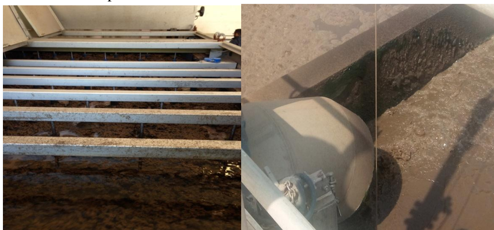
Figure 36 : boue de recirculation
