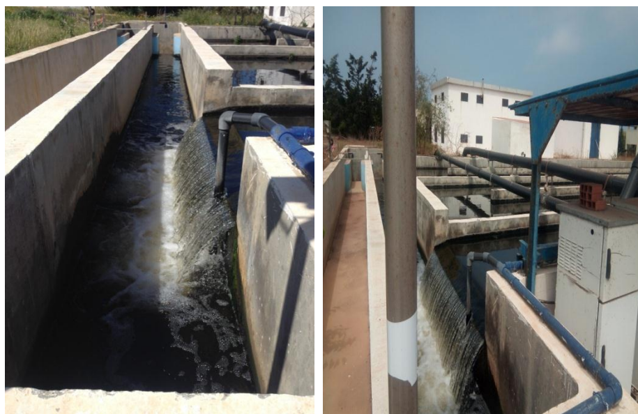
Figure 37 : bassin de Chloration
