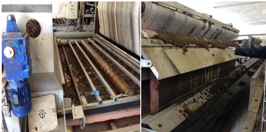
Figure 40 : Déshydratation des boues
