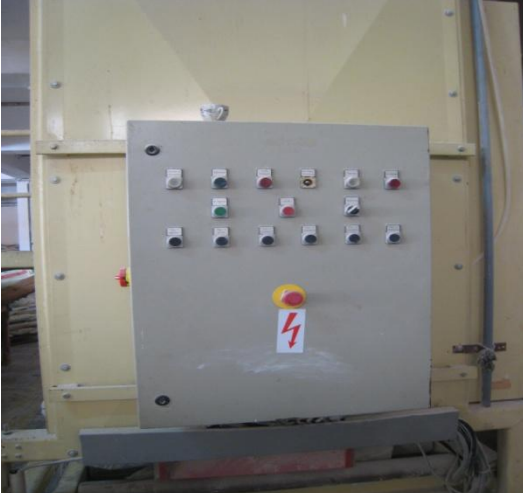
علبة كهربائية عليها إشارة توضيحية لخطر الكهرباء
