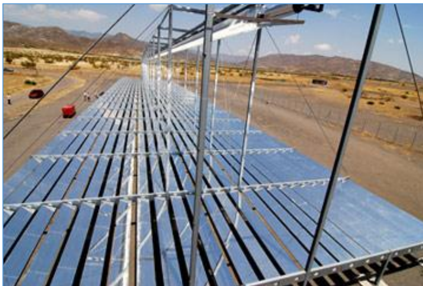
Figure 2.5 : Photo de la centrale LFR.
