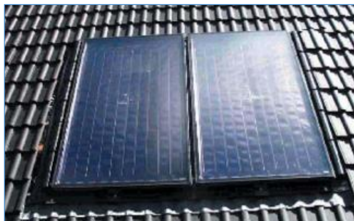
Figure 1.10 : Energie solaire thermique.
