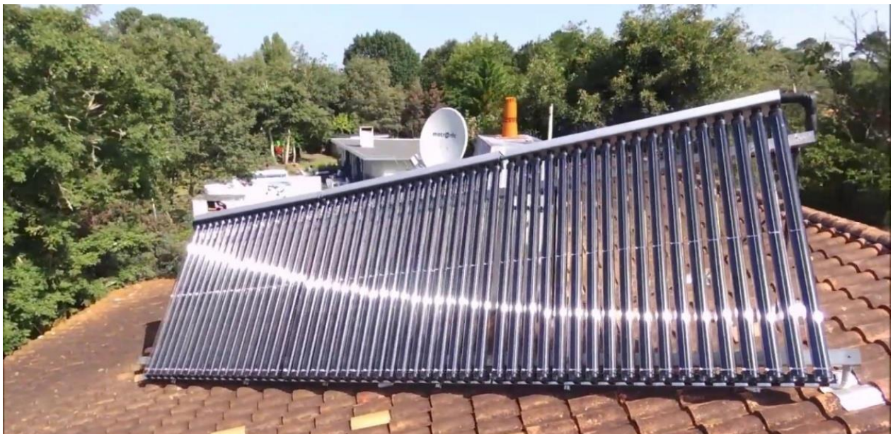
Figure 1.13 : Capteur à tubes sous vide.
