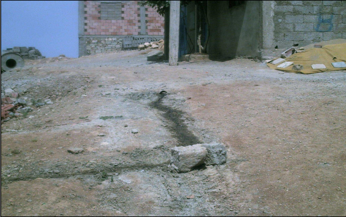
صورة رقم 11: تبين عدم الربط بشبكة الصرف الصحي في حي الحمري
