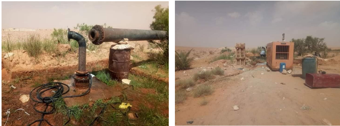
Photo 30. À droite: le forage d'El Zamala en état de réparation, périmètre d'Oued Hassi Lefhal ; à gauche : un groupe d'électrogène pour la production d'électricité
