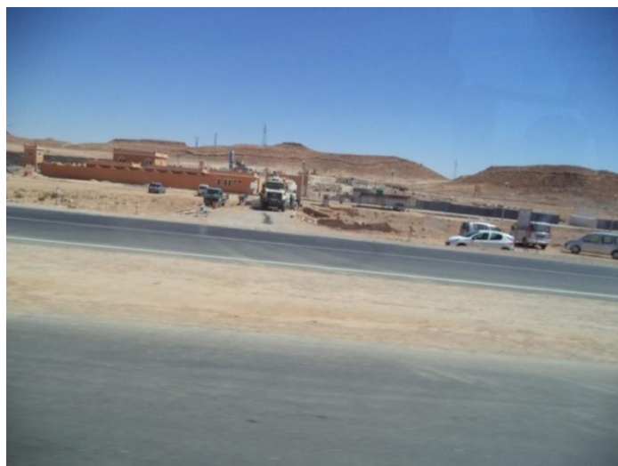
Photo 52. La nouvelle centrale pilote en panneaux photovoltaïques d'Oued Nechou Source : Addoun T., 2018.
