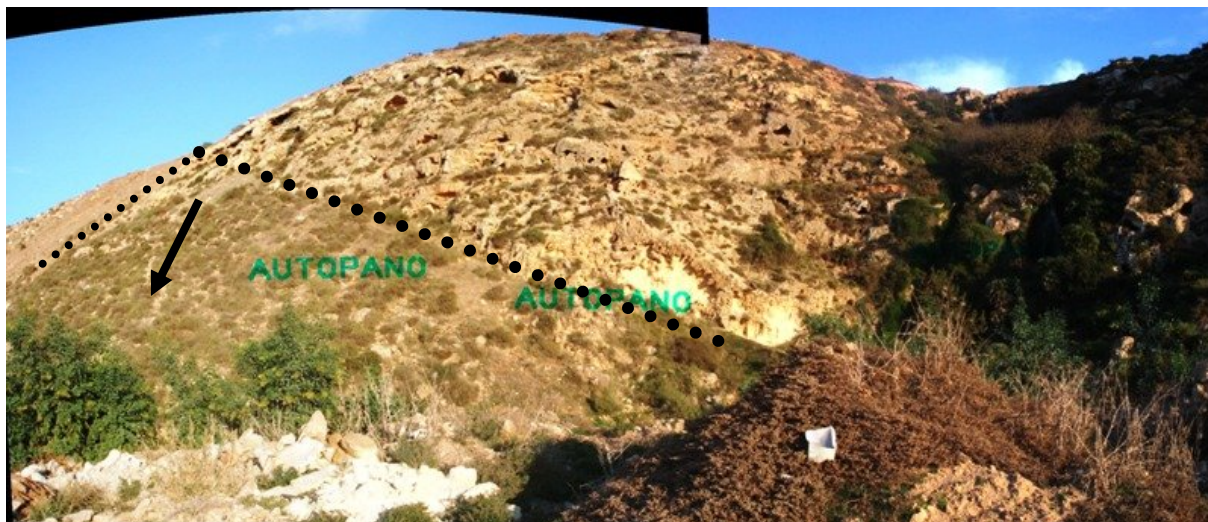
Fig.188 : Glissement au contrebas du Bahia Center
