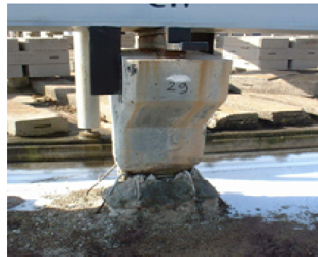
Fig. I-7 des fissures horizontale
