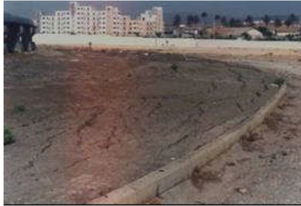
Fig. I-4 des fissures autour du bac
