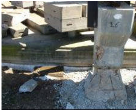
Fig. I-6 l'écaillage du béton
