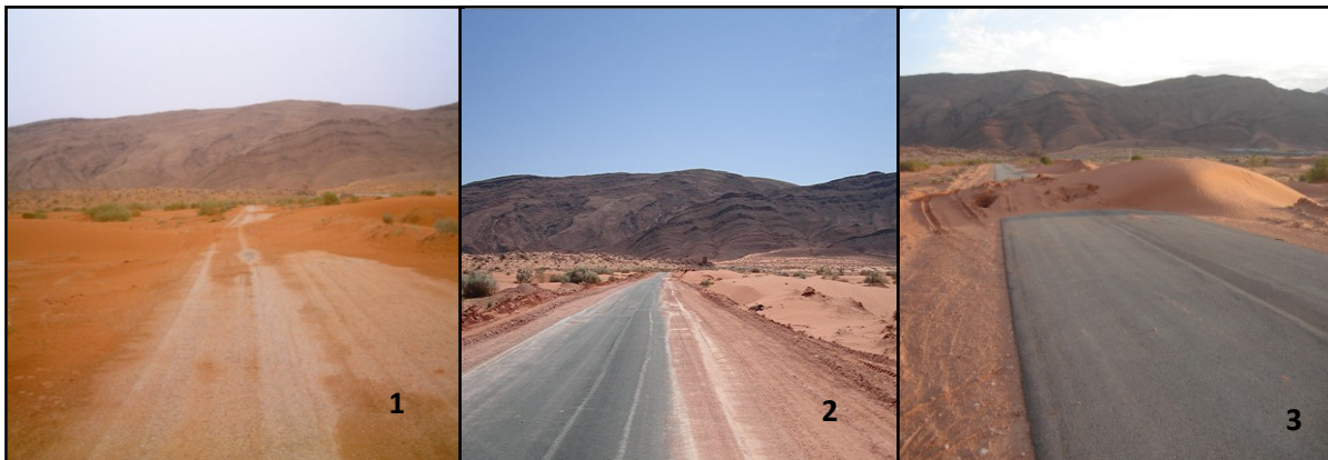
Photo 25 : Route de Tiout réalisée en l'an 2000 : 1 : en mai 2006 ; 2 : en mars 2008 ; 3 : en octobre 2008.
