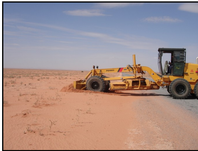
Photo 24 : Route d'Aïn Benkhelil, souvent barré par les accumulations sableuses.
