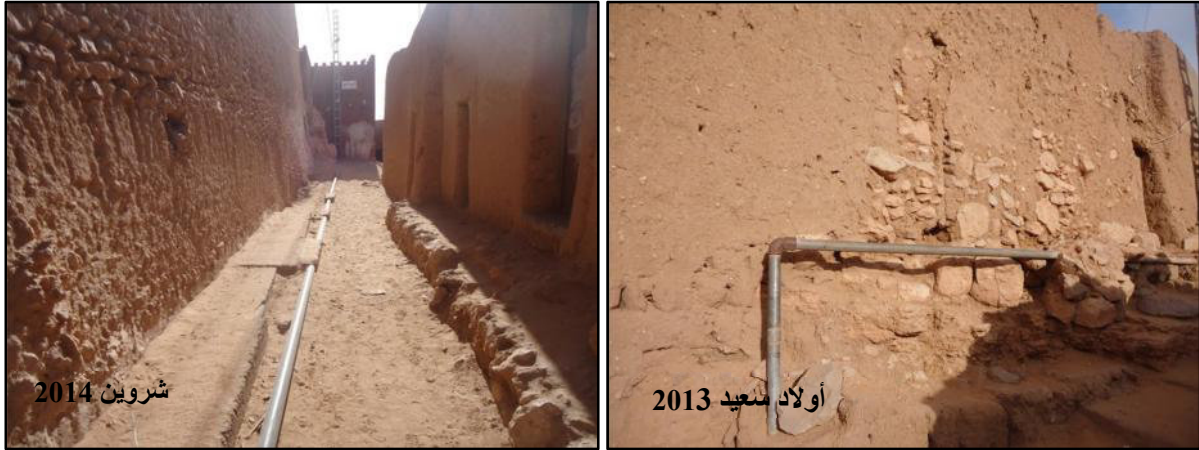
الصورة (27): شبكة المياه داخل النسيج التقليدي للقصر بالمجمعات المدروسة
