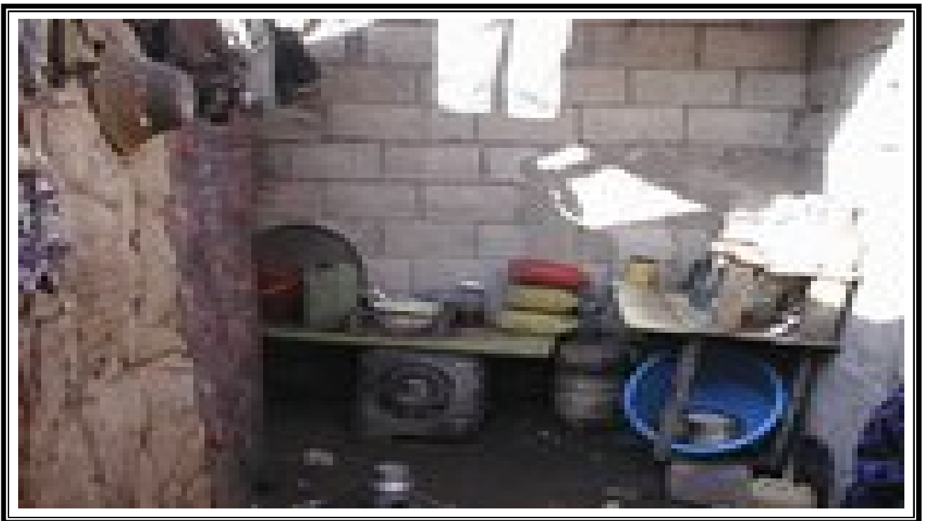
Photo N° 04 : Cette photo illustre le niveau d'habitabilité très dégradé au niveau des baraques.
