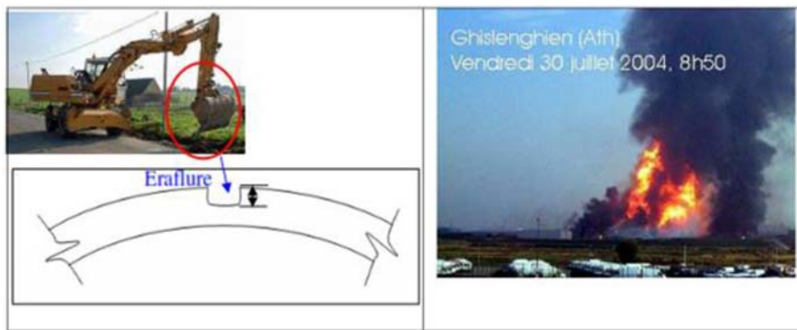
Figure I.16 : Engin de chantier en travaux [10] Figure I.17 : Photo d'une explosion d'un tuyau de gaz impacté par un godet d'un engin [10]
