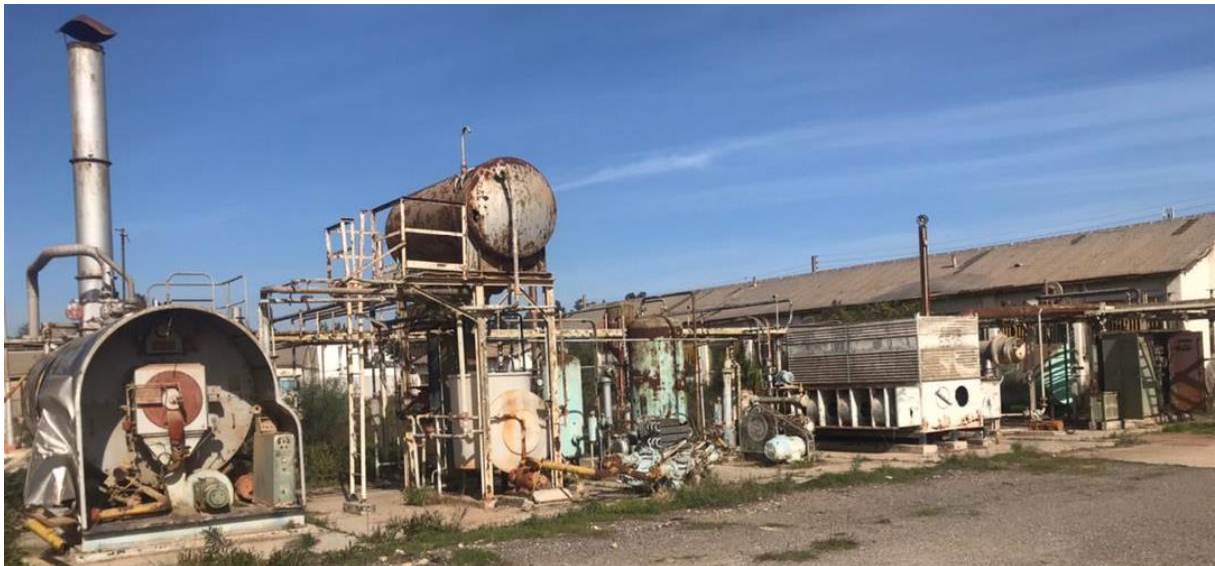
Figure III.5. Vue de la centrale thermique d'UPCA : Unité pédagogique Contrôles et Applications
