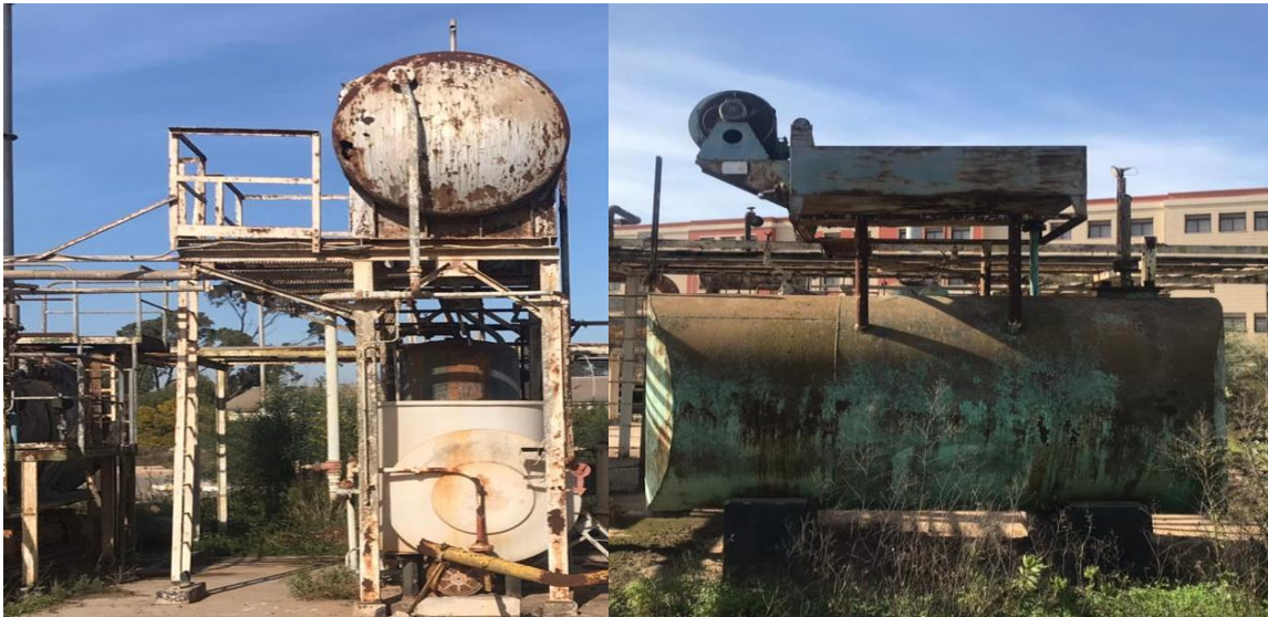
Figure 26: Vue des systèmes de traitement des eaux à l'UPCA : Unité pédagogique Contrôles et Applications
