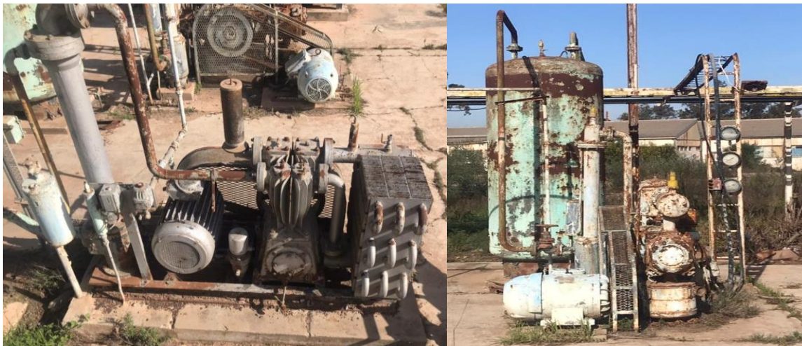
Figure 29: Vue des compresseurs BURTON et CREPELLE à l'UPCA : Unité pédagogique Contrôles et Applications
