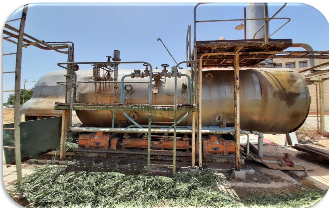
Figure III.6.une Chaudière à vapeur
