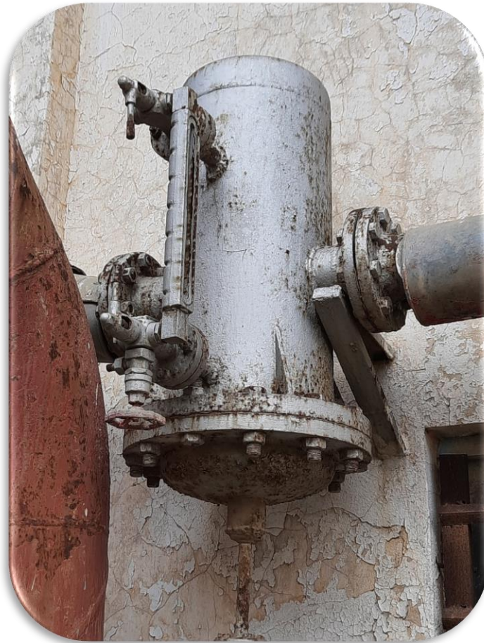
Figure III.9. Ballon sécheur séparateur d'eau et de vapeur
