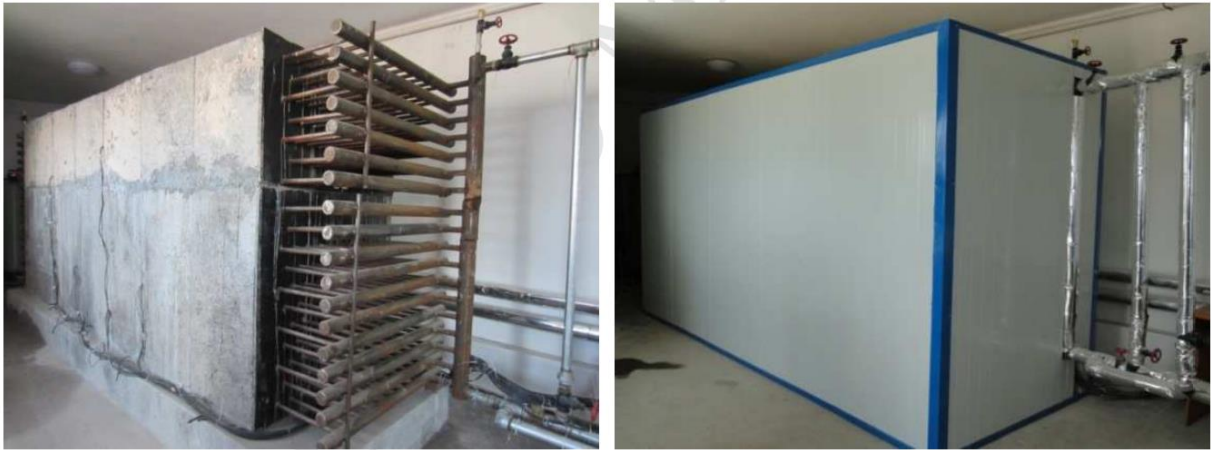
Figure III-13 : Module de stockage en béton et banque de tubes avant et après l'isolation [84].
