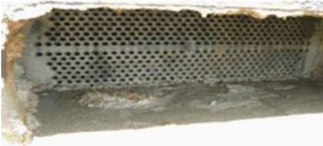
Figure I.14 Dépôt de slime bactérien, hydrocarbures et oxydes métalliques dans un échangeur de chaleur eau hydrocarbures (Raffinerie de pétrole)
