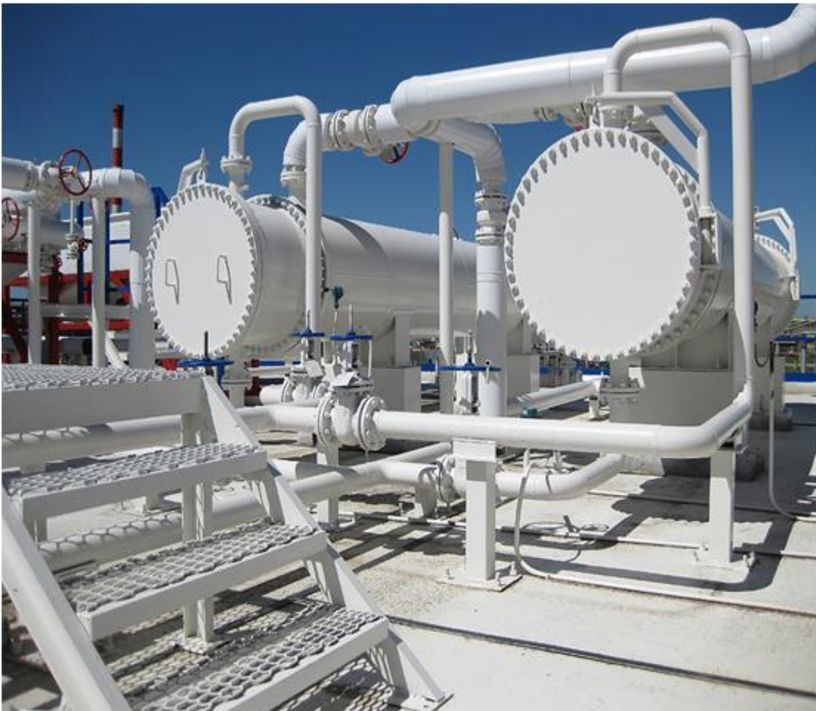
Figure I.1 Echangeur de chaleur
