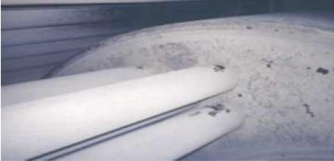
Figure I.12 Entartrage d'une chaudière à tubes de fumée (P=15 bar)
