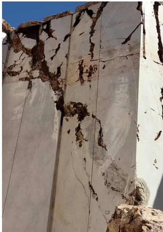
Photo 01 : faille secondaire 1 dans au niveau du septième gradin
