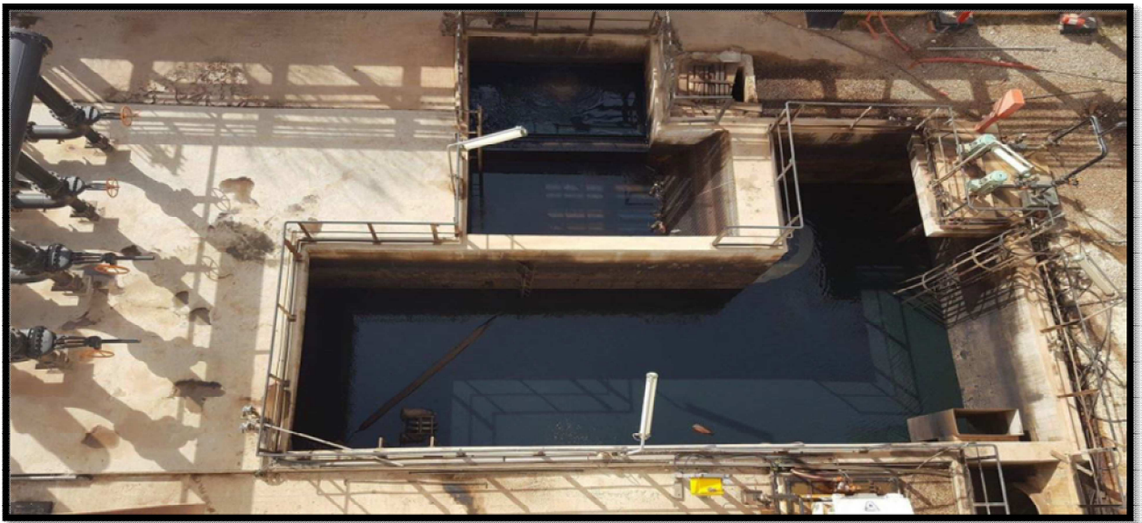
Fig.7 – Déversoir et bassin d'orage ( Bendjebbar I, 2015)
