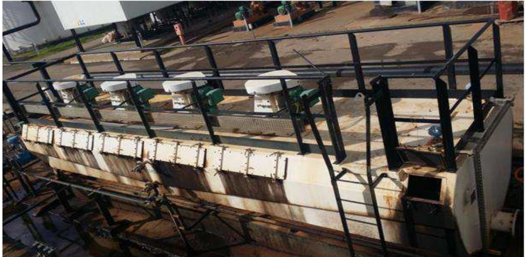
Fig. 10 - Unité de flottation (Quadricell separators- US FILTER).
