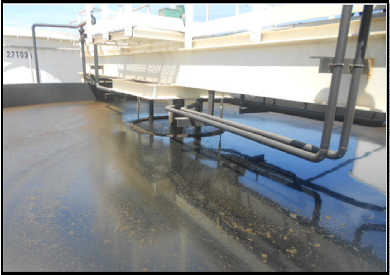
Fig.12 – Bac de rétention ( Bendjebbar I, 2015)
