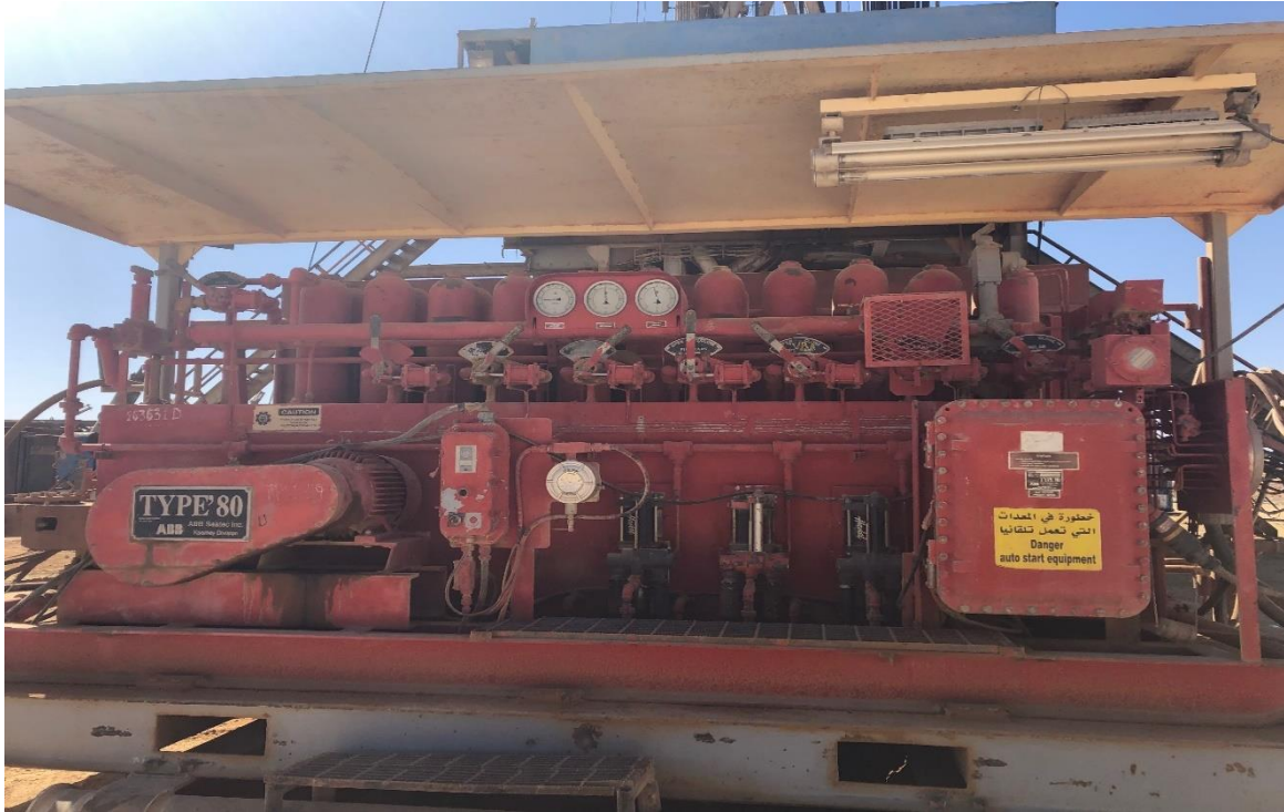
Figure III.20 : unité de commande des BOP
