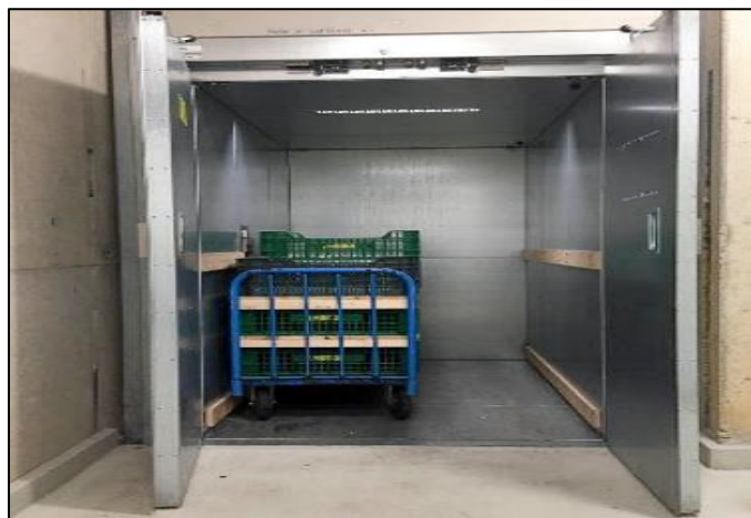
Figure I.2 : Ascenseur de charge
