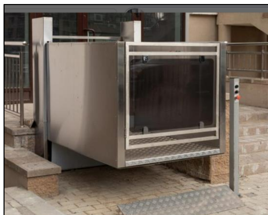
Figure I.3 : Ascenseur pour personnes à mobilité réduite
