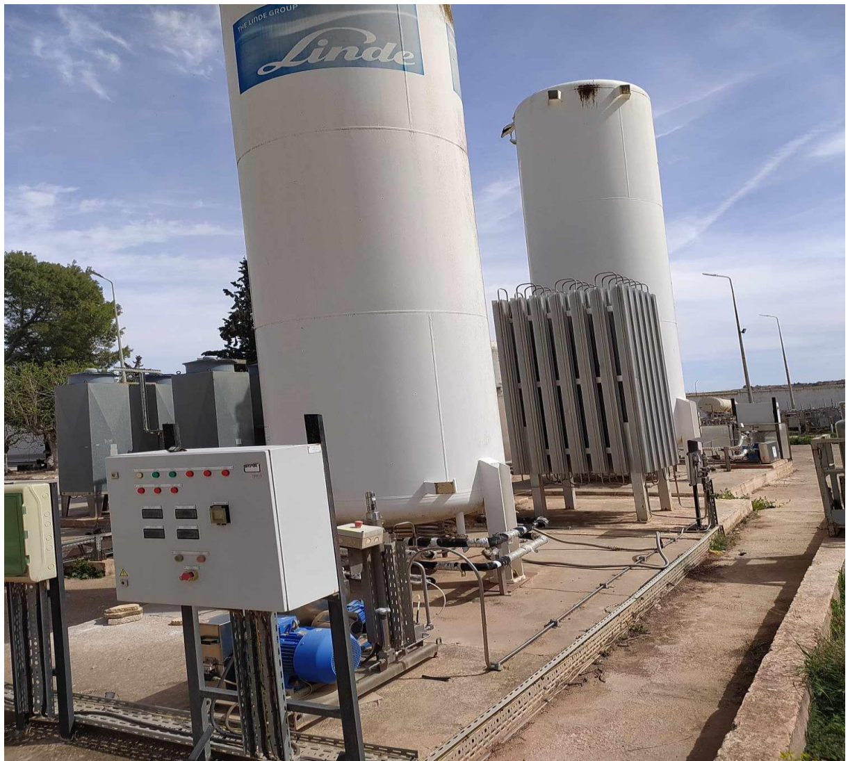
Figure 17. Unité de stockage l'azote liquide.
