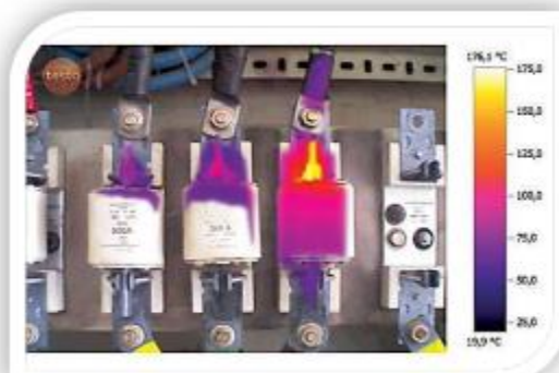
Une image thermique d'un groupe de fusibles montrant un défaut de connexion
