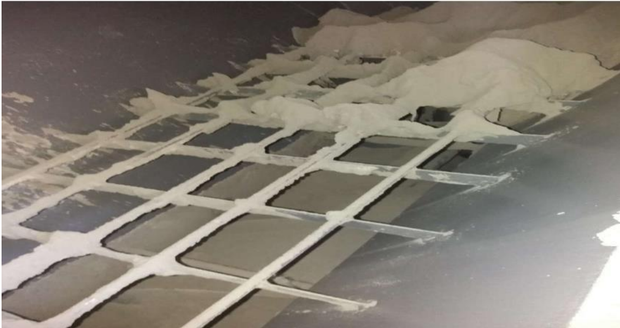
Figure IV 5: Poussières dans la trémie.
