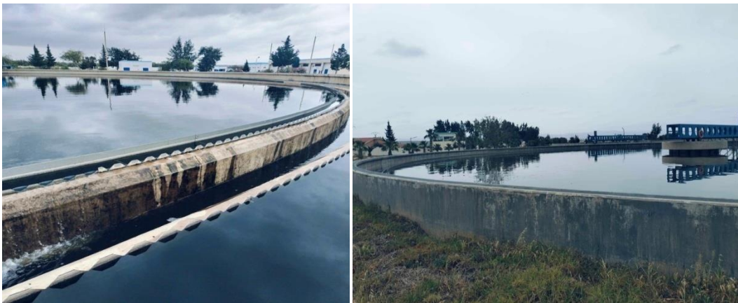
Figure 3.6 :Décanteur secondaire de la STEP El-KARMA.
