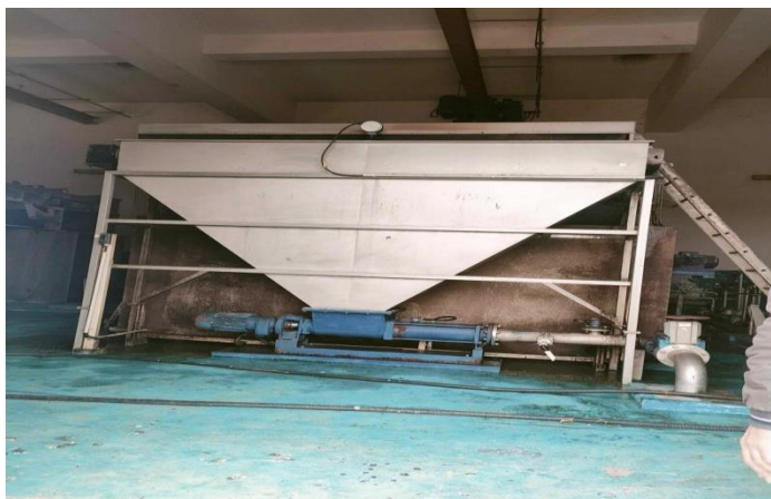
Figure 3.7 : Fosse de pompage de boue.
