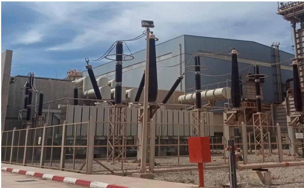
Figure 2.9 : les transformateurs de la centrale
