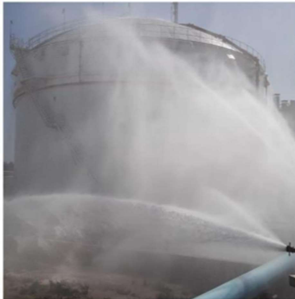
Fig.5.6. Démarrage des lances monitors à balayage automatique [20].
