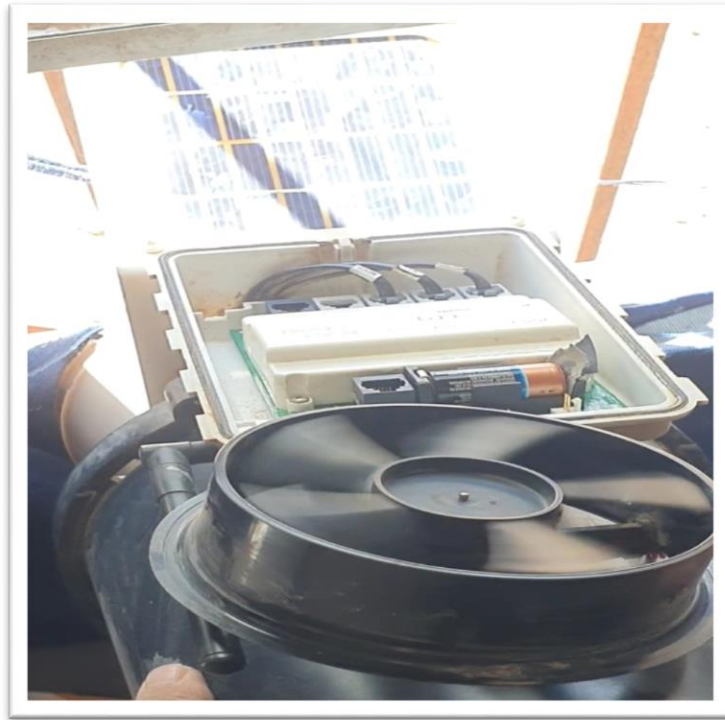
Figure 4.34: Test de ventilateur avec panneaux solaire
