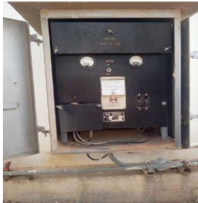
Figure 31 : Poste du Soutirage
