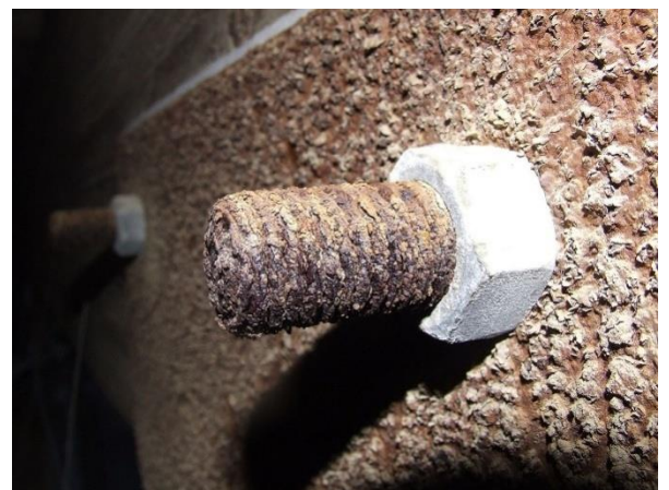
Figure 4 : Une vieille vis corrodée par le temps
