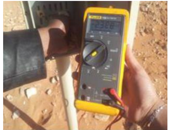
Figure 33 : Mesure du potentiel d'une conduite enterrée à l'aide d'un multimètre
