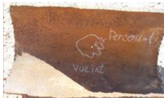
Figure 23 : Percement d'une conduite enterrée (vue interne)
