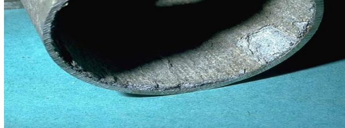
Figure 6 : Corrosion feuilletante d'une canalisation en alliage d'aluminium véhiculant de l'eau
