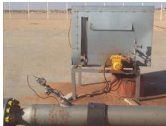
Figure 30 : Pompe doseuse responsable à injecter l'inhibiteur de corrosion
