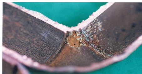
Figure 7 : la corrosion sous contrainte
