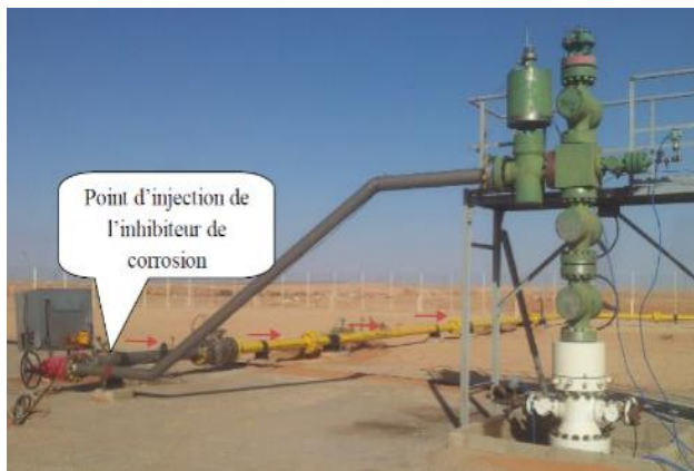
Figure 29 : Point d'injection de l'inhibiteur de corrosion au niveau du puits
