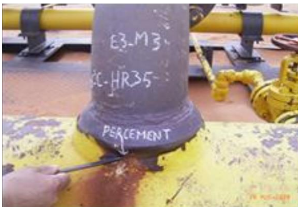
Figure 24 : Le contrôle visuel des conduites corrodées
