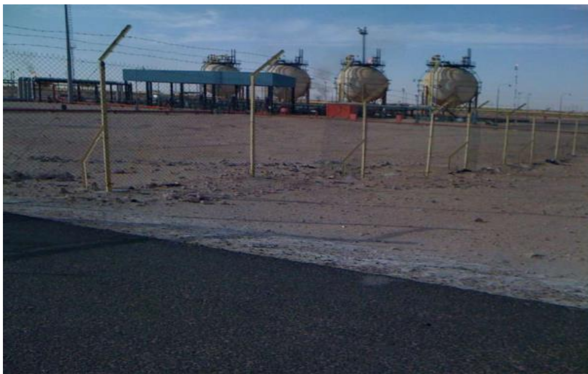
Figure III.2: Les sphère de stockage GPL ZSINA
