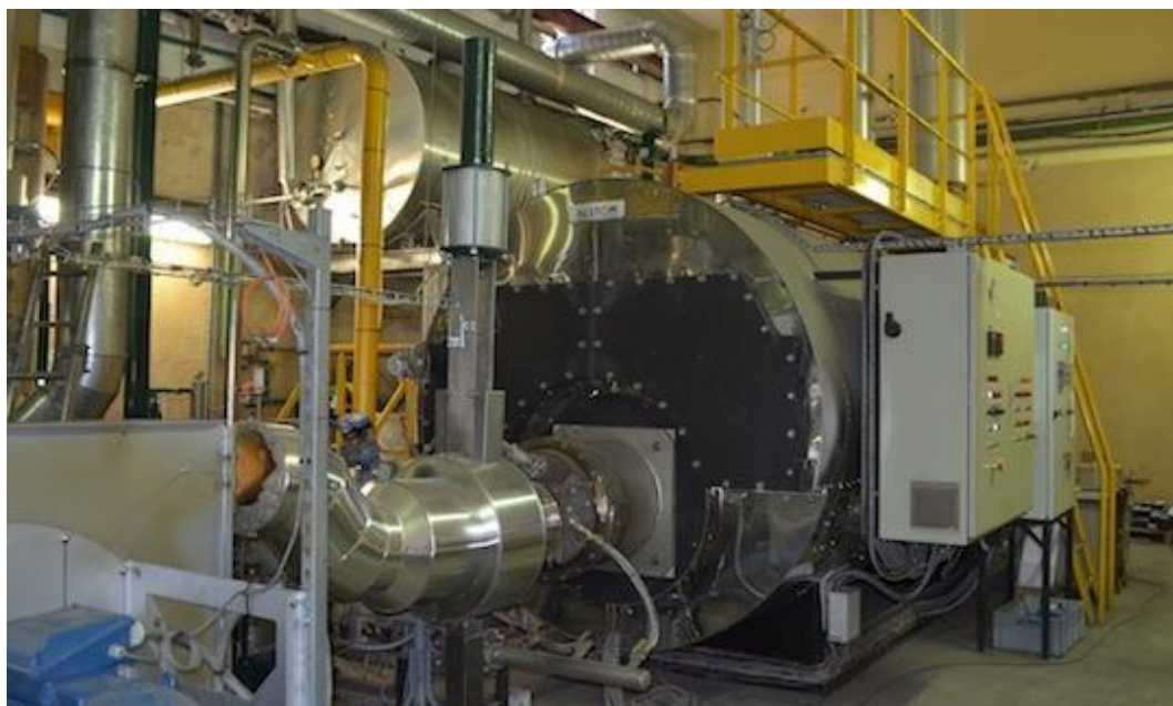
Figure 03 : Chaudière au niveau de la CU2
