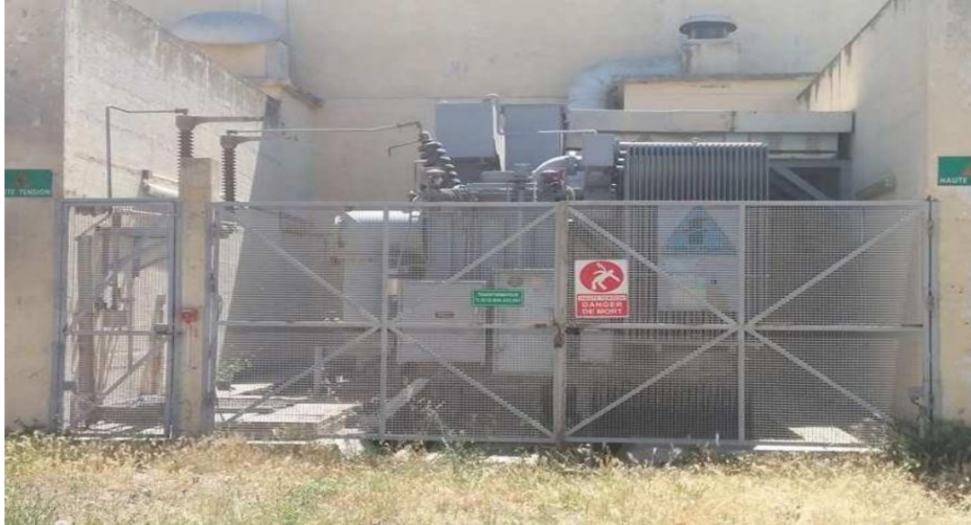
Figure VII.5 : Transformateur T 3 63/5.5 KV
