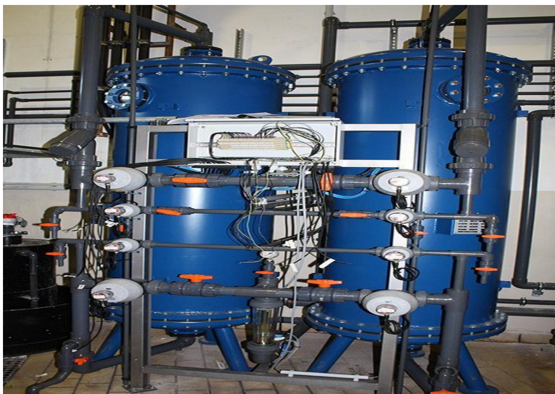
Figure 02 : Section déminéralisation des eaux
