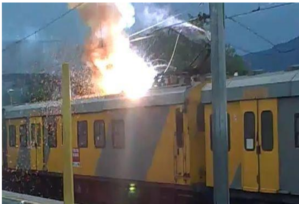
Figure 05 : Explosion d'origine électrique
