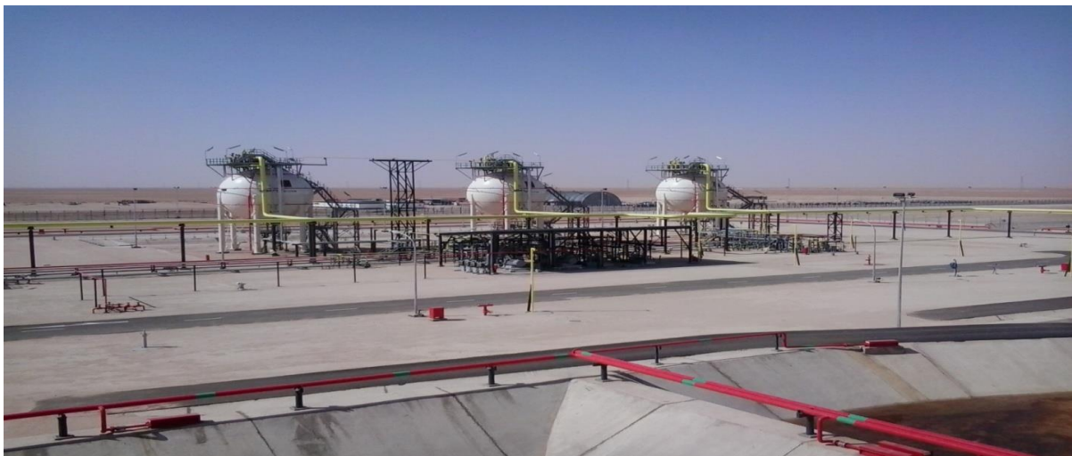
Figure –IV-a-la zone de stockage de GPL.
