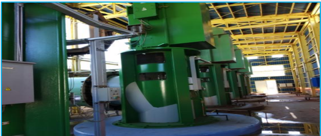
Figure 3.11 : La station de pompage
