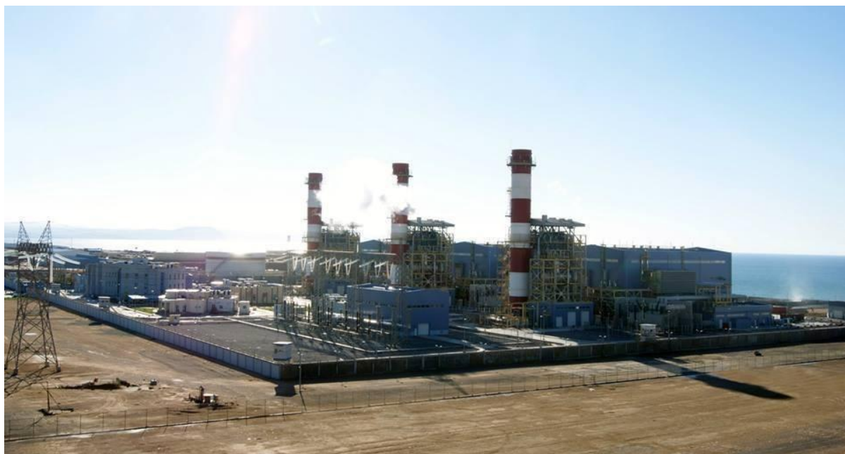
Figure 3. 1 : La centrale électrique
