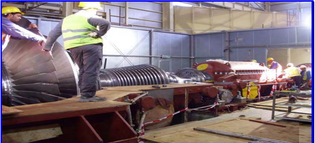
Figure 3.8 : la turbine à vapeur
