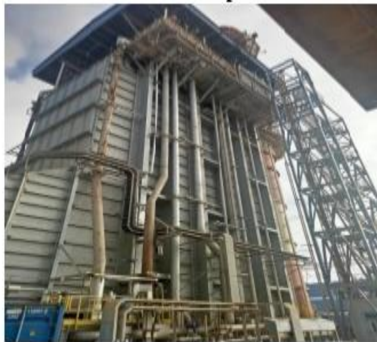
Figure 3.9 : Chaudière de récupération
