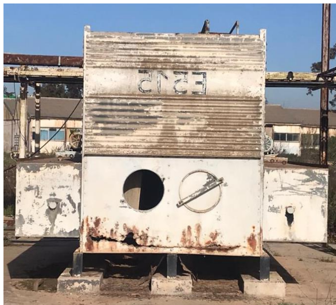
Figure 21: Vue de la tour de refroidissement à l'UPCA
