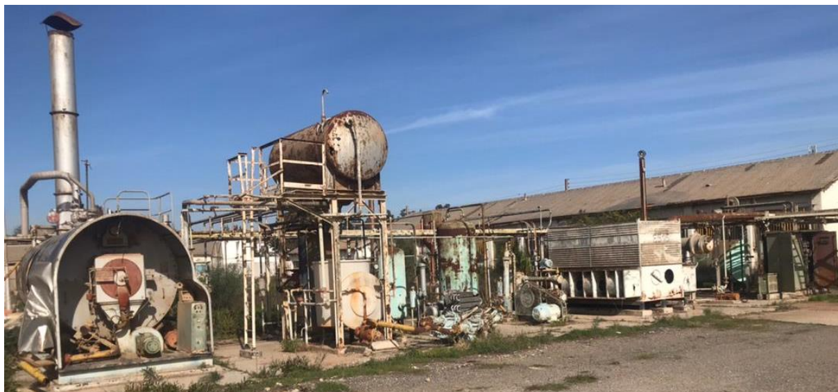
Figure 17 : Vue de la mini-centrale thermique unité 500 d'UPCA
