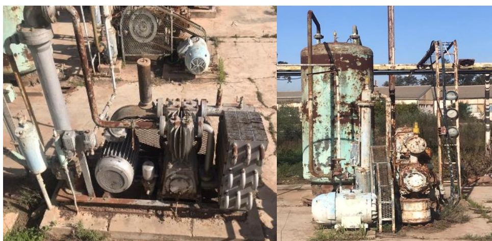
Figure 22: Vue des compresseurs BURTON et CREPELLE à l'UPCA
