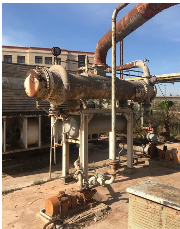
Figure 19: Vue du condenseur d'UPCA
