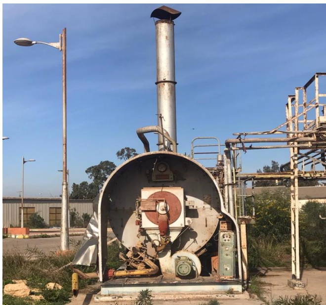
Figure 18: Vue de la chaudière STEAMBLOC d'UPCA
