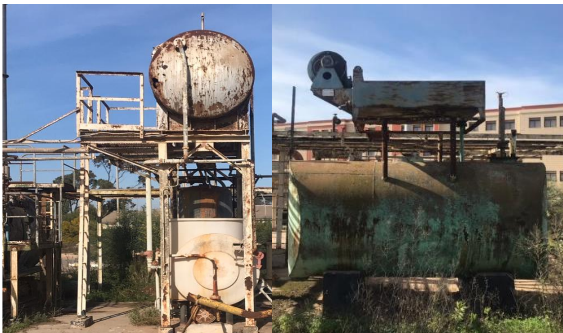
Figure 20 : Vue des systèmes de traitement des eaux à l'UPCA
