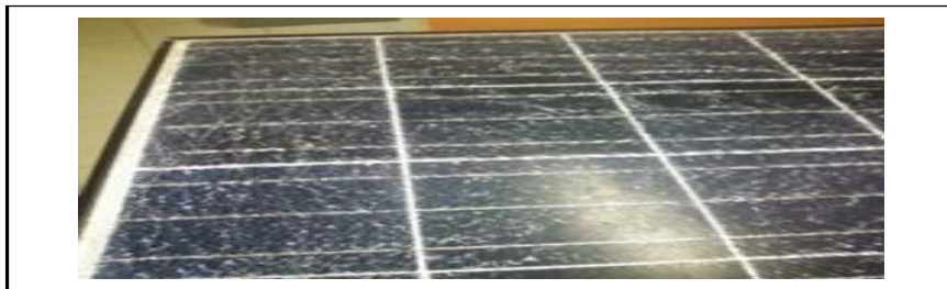
Figure 2.11 Module photovoltaïque présentant des bris de verre [5].
