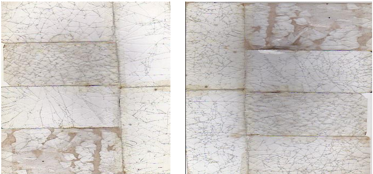
Figures 4.7 Les plaques fissurées
