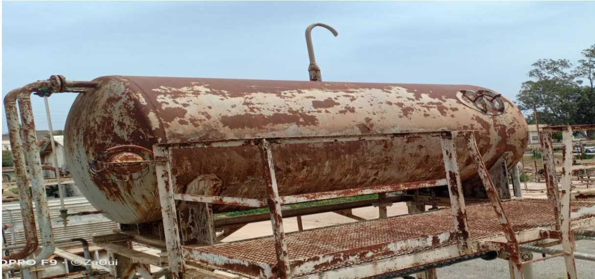
Figure 10 : vue du réservoir à condensat.
