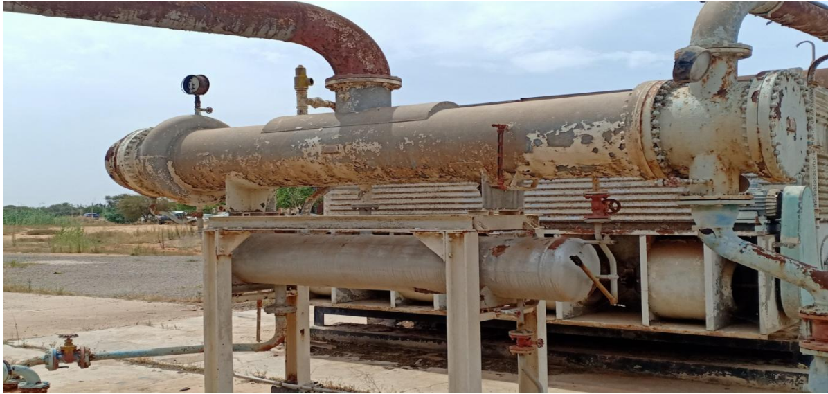
Figure 13 : vue de condenseur atmosphérique et leur pot de condensation.
