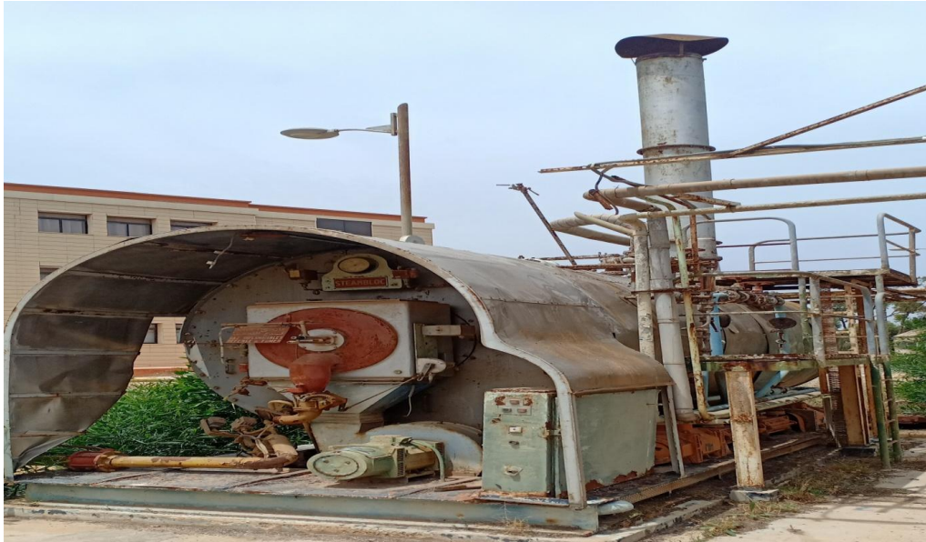
Figure 7: vue de la chaudière STEMBLOC.
