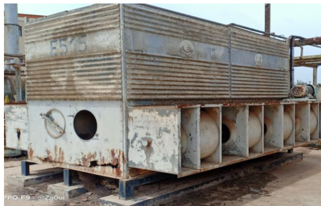
Figure 14 : vue de tour de refroidissement.
