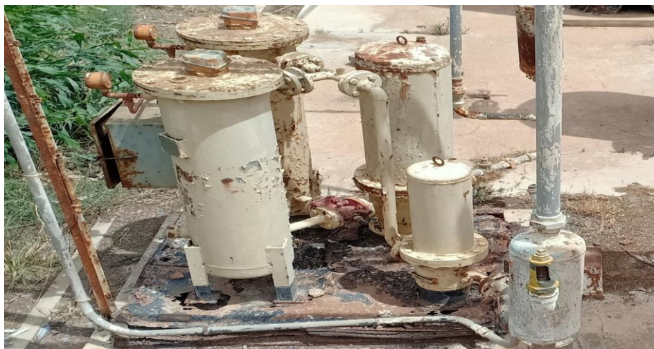
Figure 16: vue de l'unité de traitement d'air.
