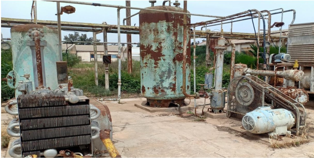
Figure 15 : vue de l'unité d'air comprimé.
